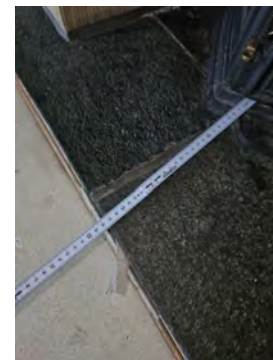
Avstand fra ilegg på ovn til brennbart gulv er mindre enn 30cm
