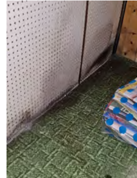
Veggplater har merker etter fukt
