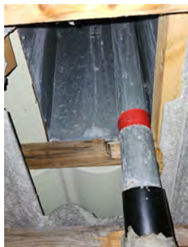
Fuktmerke i nerkant av luftehatt
