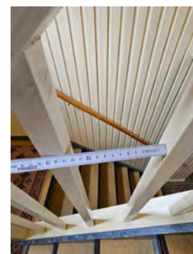
Åpning mellom spiler i rekkverk er ca 13 til 14cm
