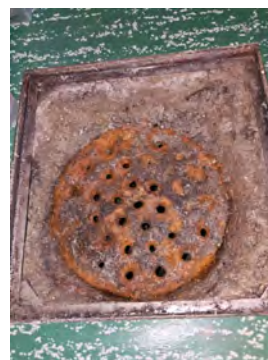
Støpejernssluk uten tetting mot gulvbelegg
