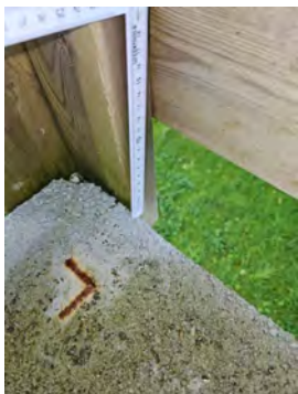
Åpning mellom dekke og rekkverk er over 10cm
