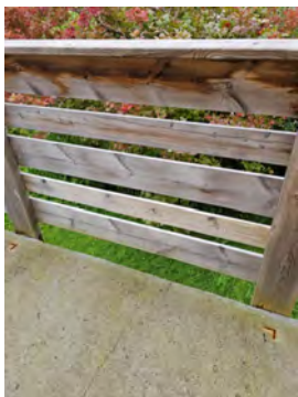
Åpning mellom spiler er over 20mm.
