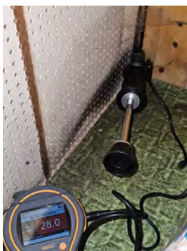
Måling i stender mot grunnmur ga utslag på fukt i konstruksjonen.
