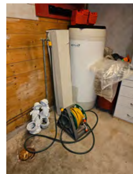
Bereder plassert i bod i kjeller
