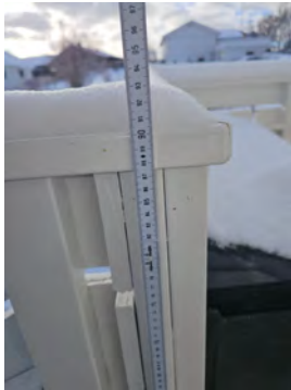
Høyde på rekkverk på terrasse er 90cm
