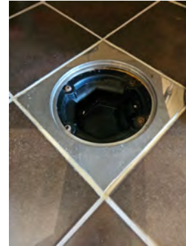
Sluk under servant fra byggeår
