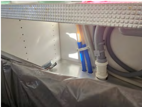
Manglende tetting på rør-i-rør i kjøkkenbenk
