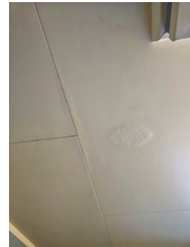
Tidligere fukskade i himling i kjeller
