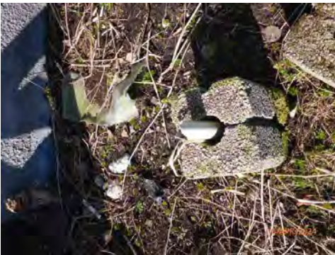
Utvendig stoppekran i nord.
